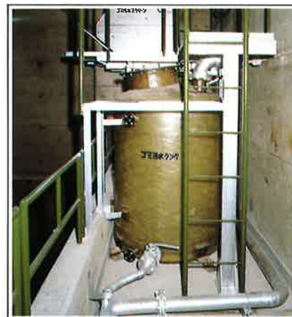
ごみ汚水タンク
