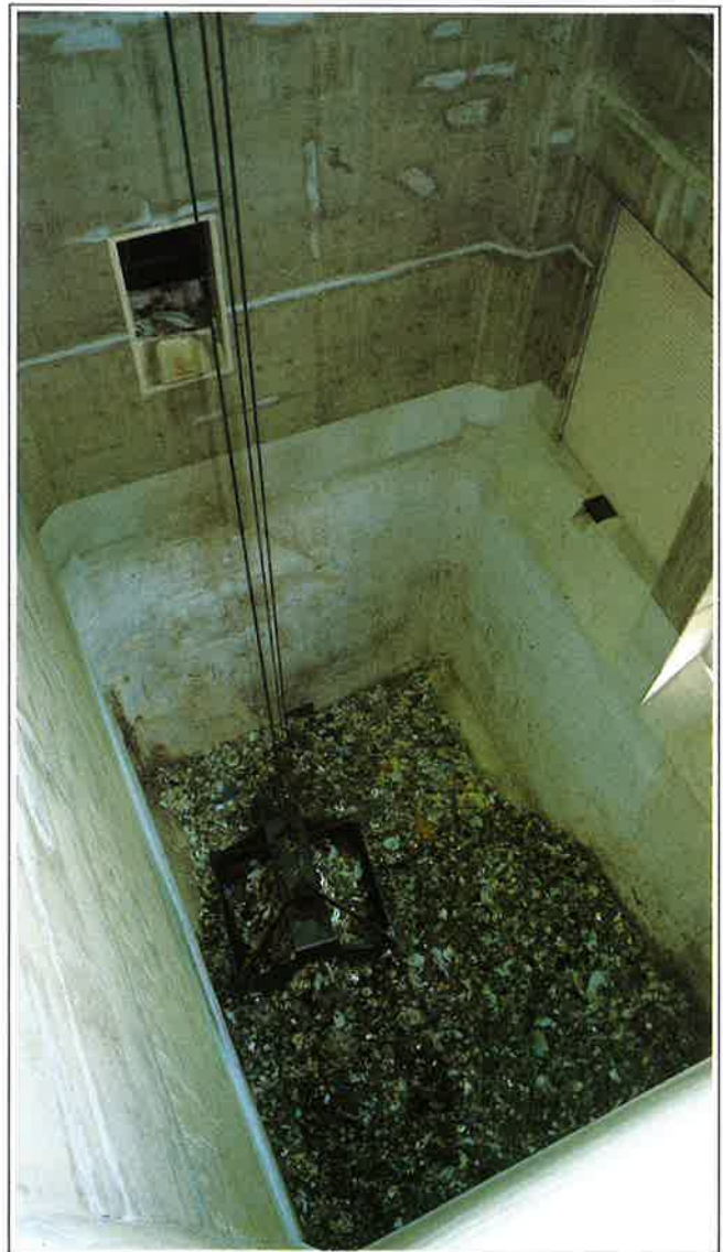
ごみピット及びごみクレーン
