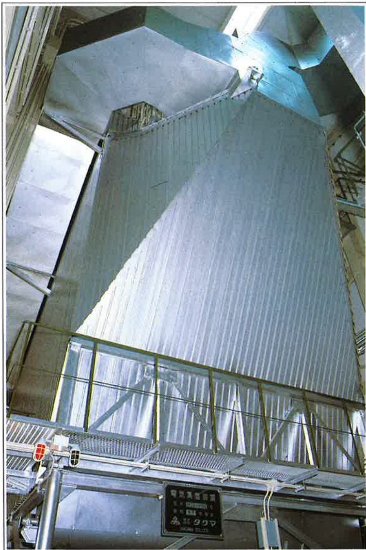
電気集じん装置
