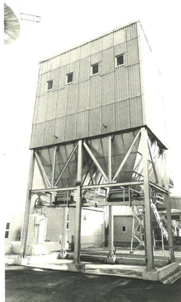
④ 灰出バンカ 灰を一時ここに貯留し適時トラックで搬出します。
