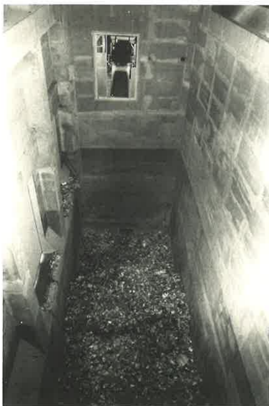
● ゴミピット 密閉式で内部の空気を燃焼用に吸引していますので、ホコリや臭気が外部へ飛散しません。
