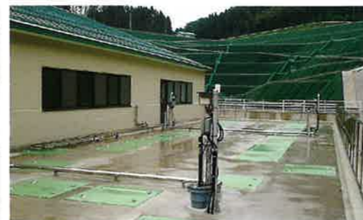
▲生物処理設備
