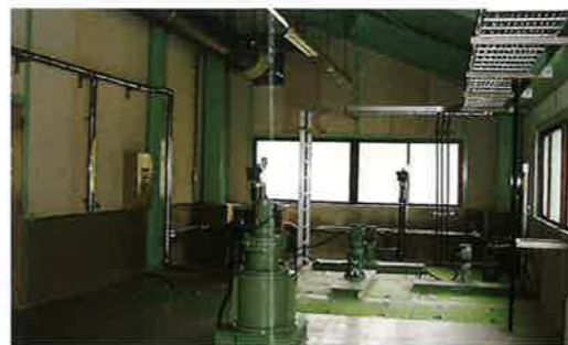
▲カルシウム除去設備
